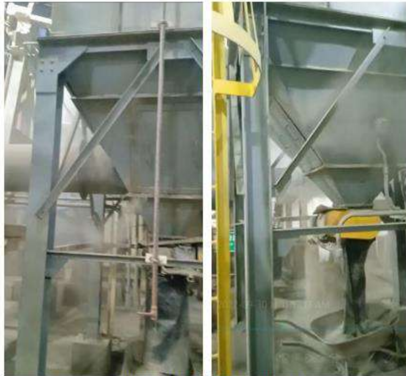
*Dos (02) colectores que funcionan en paralelo.
